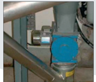
Bild 32. Zellradschleuse am Sammeltrichter des Zyclons montiert
