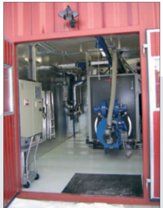
Bild 3. Die komplette Technik in einem Raum
