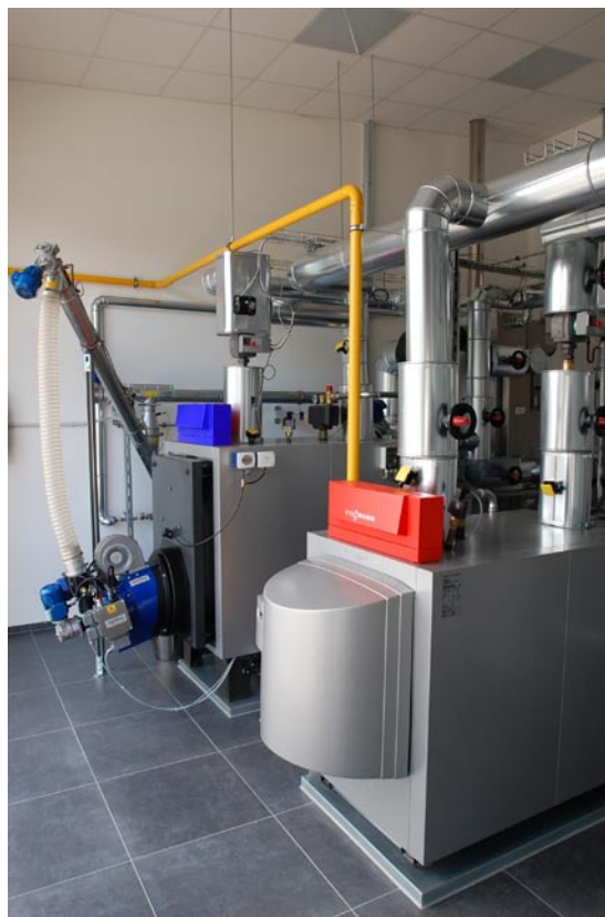
Referenzanlage 1 (150 kW Pellets + Gas)
