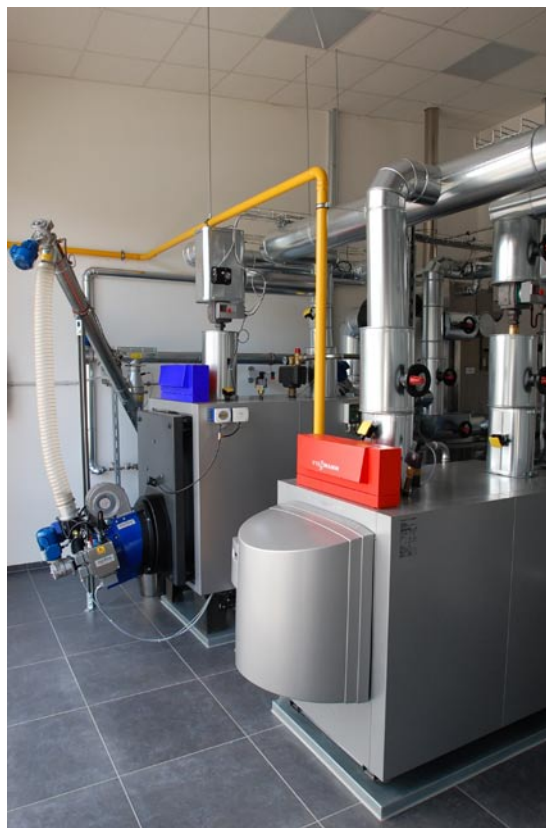
Referenzanlage 1 (150 kW Pellets + Gas)
